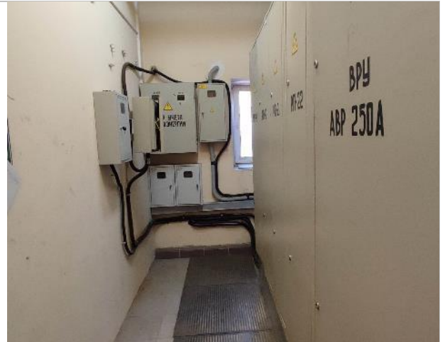
Фотография 38. 1 этаж. электрощитовая вход с улицы. (внутренние помещения)
