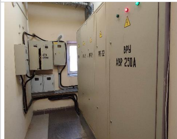
Фотография 41. 1 этаж. электрощитовая вход с улицы. (внутренние помещения)
