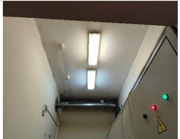
Фотография 40. 1 этаж. электрощитовая вход с улицы. (внутренние помещения)
