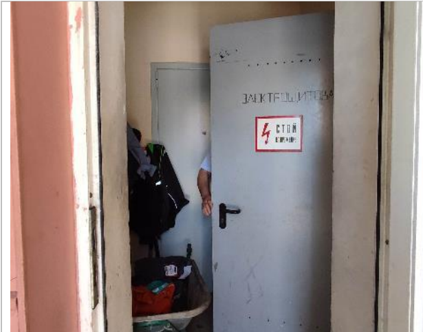
Фотография 37. 1 этаж. электрощитовая вход с улицы. (внутренние помещения)
