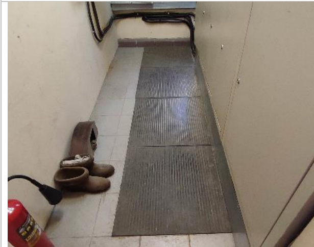
Фотография 39. 1 этаж. электрощитовая вход с улицы. (внутренние помещения)
