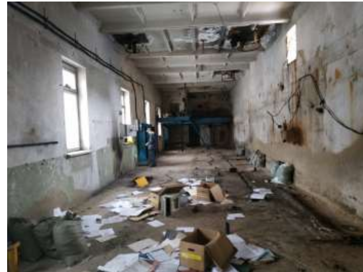
Внутренние помещения здания котельной
