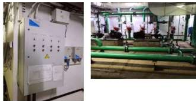
Помещенияльная пожарная станция системы противопожарной защиты
