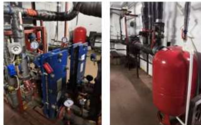
Размещение тепломеханического оборудования ИТП
