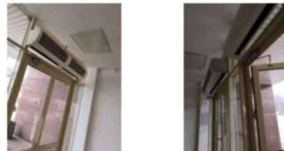
Входные группы с тепловыми завесами.
