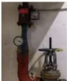
Узел ввода ХВС с водомерной выставкой
