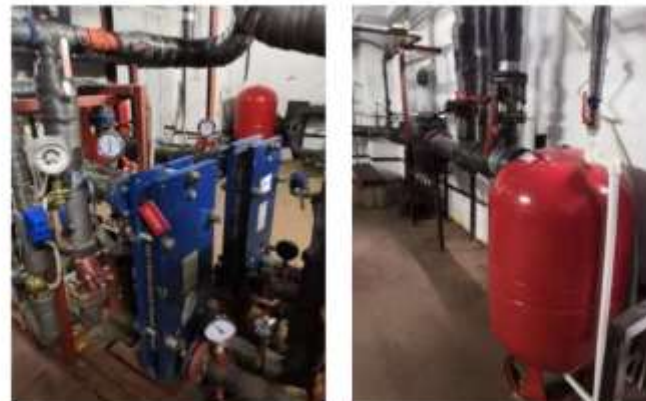
Размещение тепломеханического оборудования ИТП
