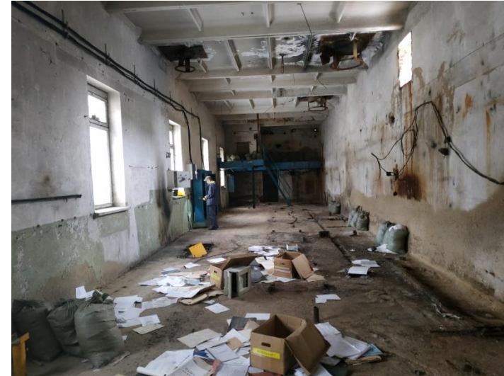
Внутренние помещения здания котельной
