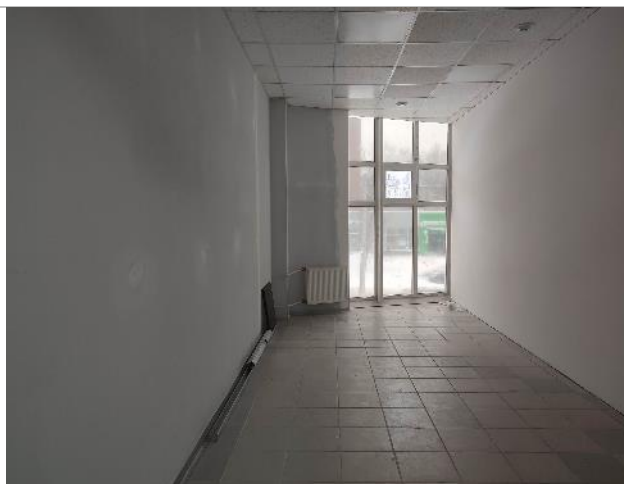
Фотография 3.10. Состояние внутренних помещений 2-го этажа
