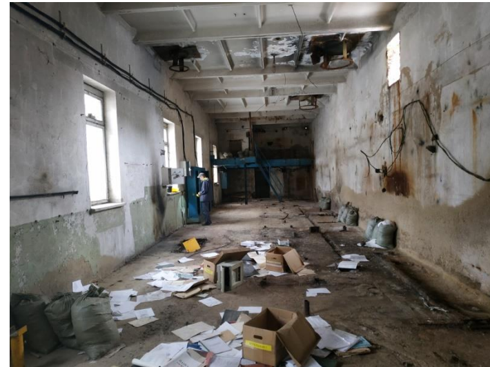
Внутренние помещения здания котельной
