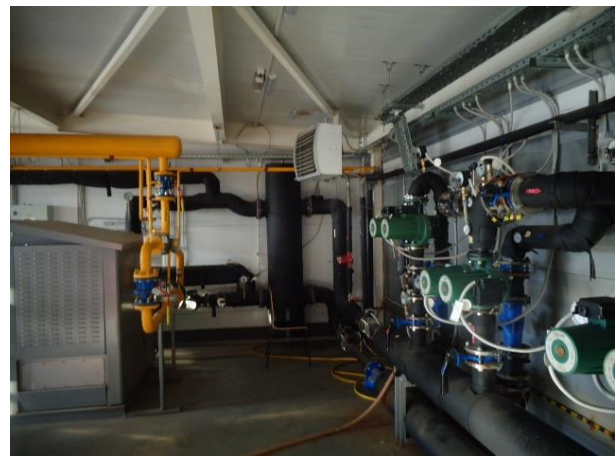
Фото № 42. Помещения котельной
