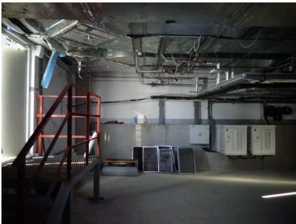
Фото № 39. Помещения котельной
