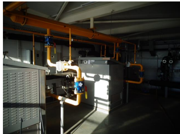
Фото № 40. Помещения котельной
