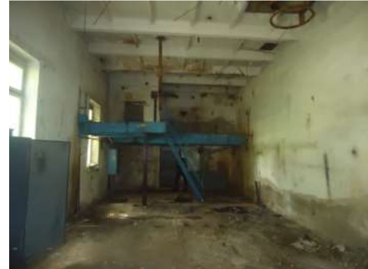
Внутренние помещения здания котельной
