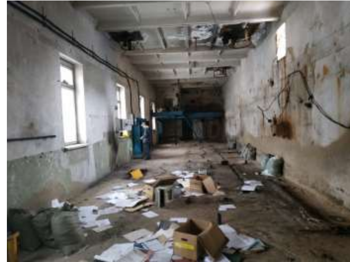
Внутренние помещения здания котельной
