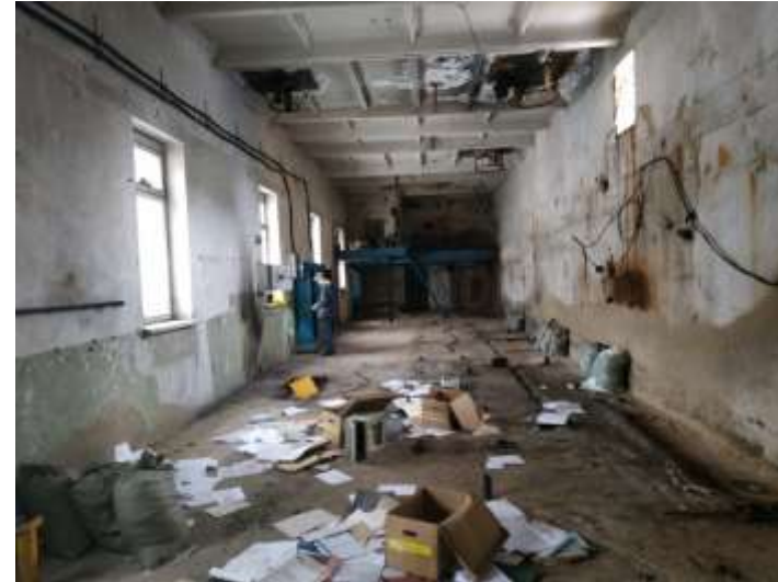
Внутренние помещения здания котельной
