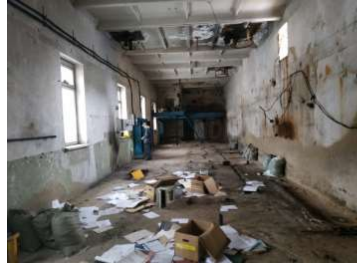
Внутренние помещения здания котельной
