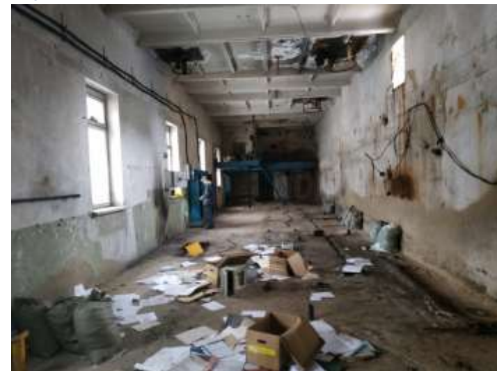
Внутренние помещения здания котельной
