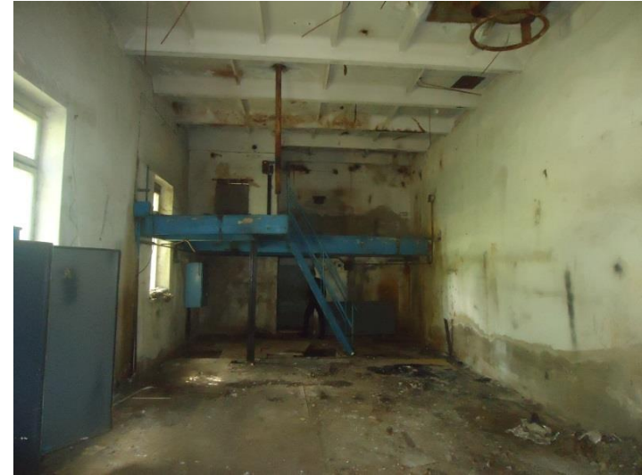
Внутренние помещения здания котельной
