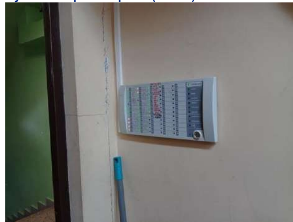
Пульт пожарной охраны (3 этаж)
