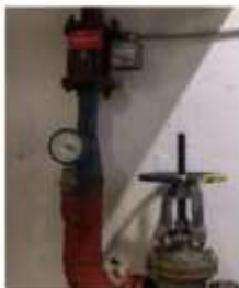
Узел ввода ХВС с водомерной выставкой
