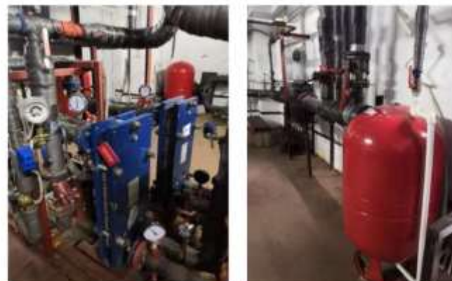
Размещение теплоэнергетического оборудования ИТП
