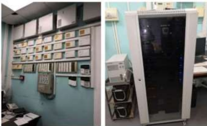
Шкаф управления системой противопожарной защиты.
