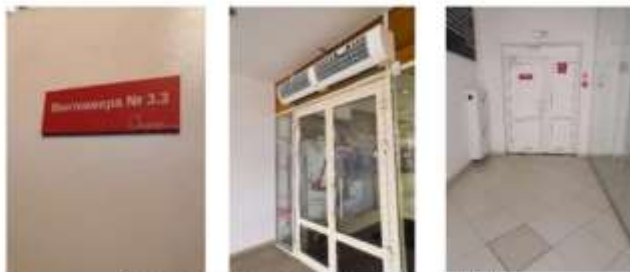
Виды заполнения дверных проемов (сталь, алюминий, ПВХ)
