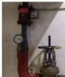
Узел ввода ХВС с водомерной выставкой
