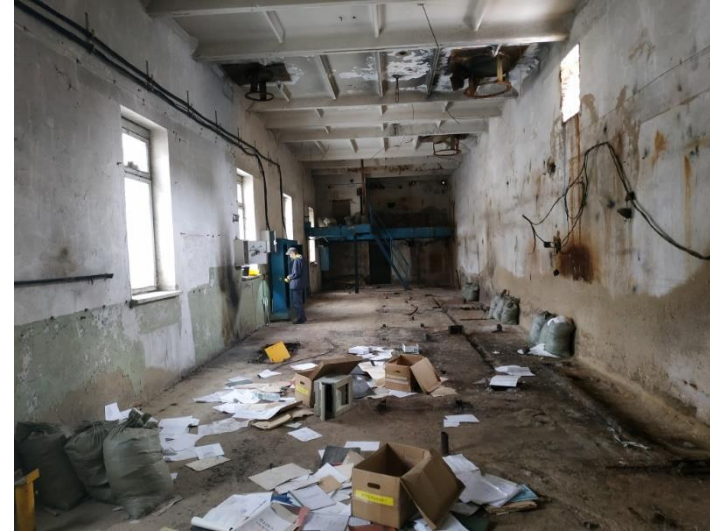
Внутренние помещения здания котельной
